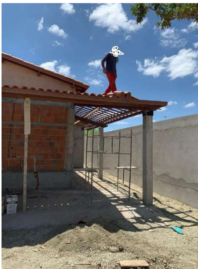
Figura 7 - Ausência de EPI
