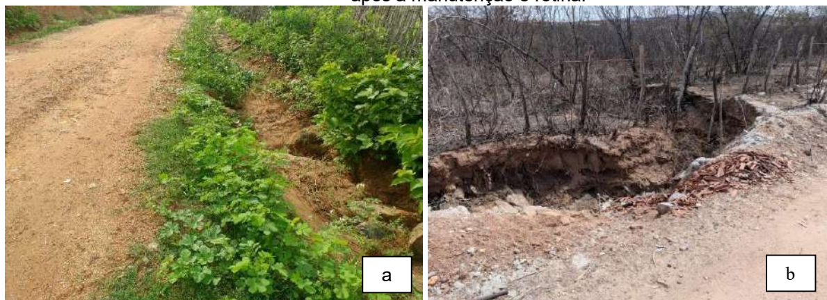
Figura 8 – Fenômeno de assoreamento: (a) buraco surgido no período chuvoso e (b) no período seco após a manutenção e rotina.
