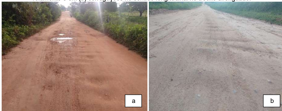
Figura 5 – Defeitos encontrados na estrada IBI-02: (a) buracos e acúmulo de água na pista de rolamento e em (b) corrugações no sentido longitudinal no trecho averiguado.
