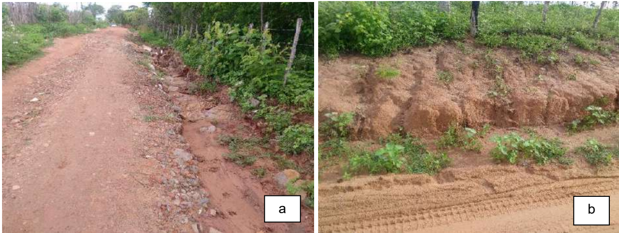
Figura 3 – Defeitos encontrados na estrada IBI-01: (a) seção transversal inadequada e drenagem lateral inadequada e (b) talude com presença de erosão.
