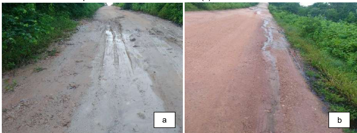
Figura 4 – Defeitos encontrados na estrada IBI-02. (a) escoamento superficial de água, afundamento por trilha de roda e atoleiro e em (b) sulcos de erosão.
