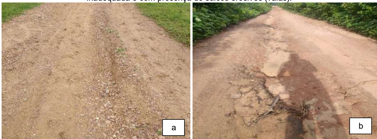
Figura 2 – Defeitos encontrados na estrada IBI-01: (a) segregação e (b) seção transversal inadequada e com presença de sulcos erosivos (valas).
