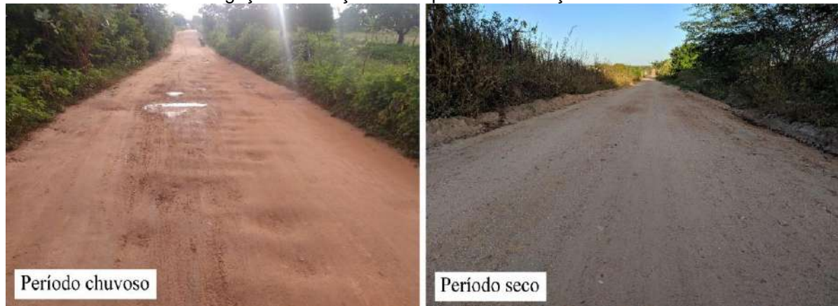
Figura 9 – Estrada IBI-02 em distintos períodos: durante a estação chuvosa, com presença de buracos e corrugações e estação seca após a manutenção de rotina realizada.
