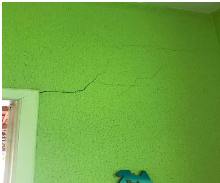
Figura 16 - Fissura na extremidade da porta - Residência 2
