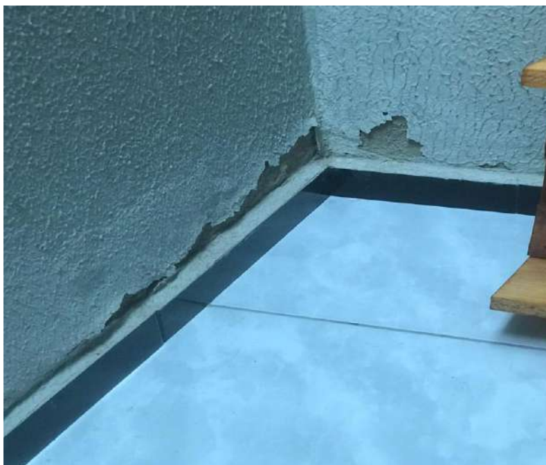
Figura 15 - Degradação do revestimento na Residência 1
