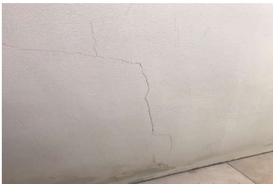
Figura 14 - Fissuras em parede da Residência 1.
