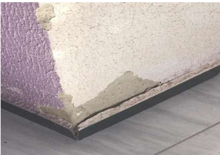
Figura 20 - Degradação do revestimento na Residência 3
