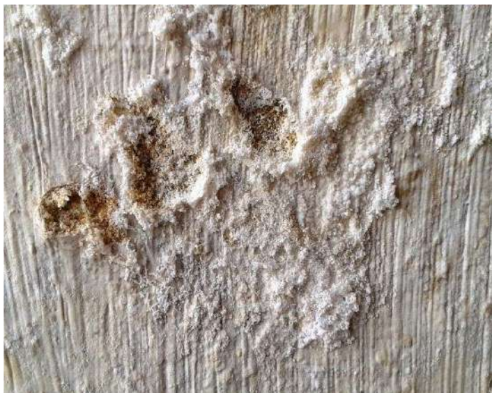
Figura 7 – Eflorescência em uma parede.
