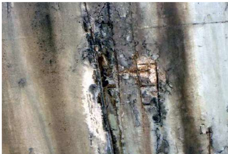
Figura 6 - Desagregação da estrutura de concreto armado.
