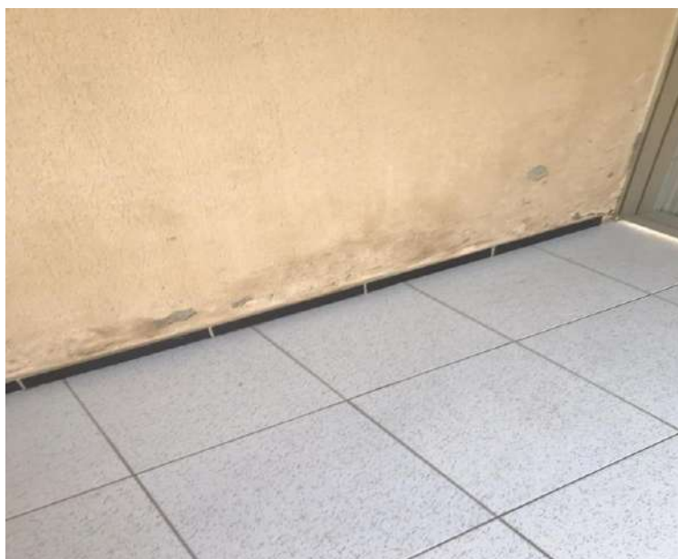
Figura 17 - Degradação do revestimento na Residência 2
