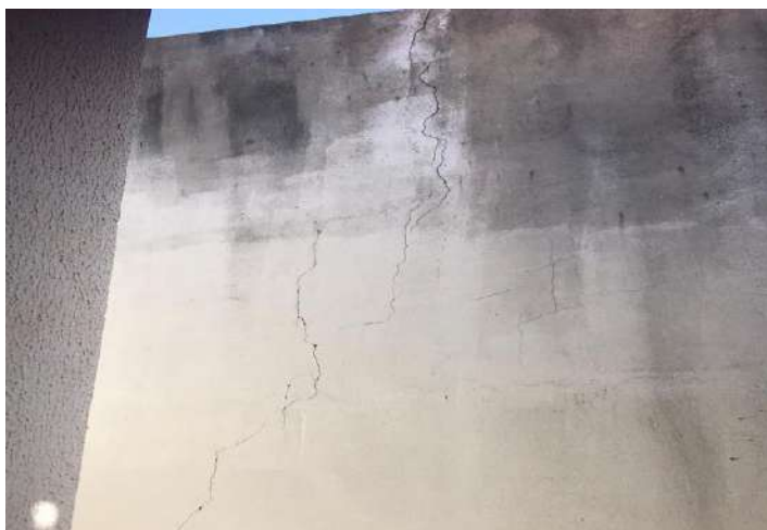
Figura 18 - Fissura no muro externo da Residência 3
