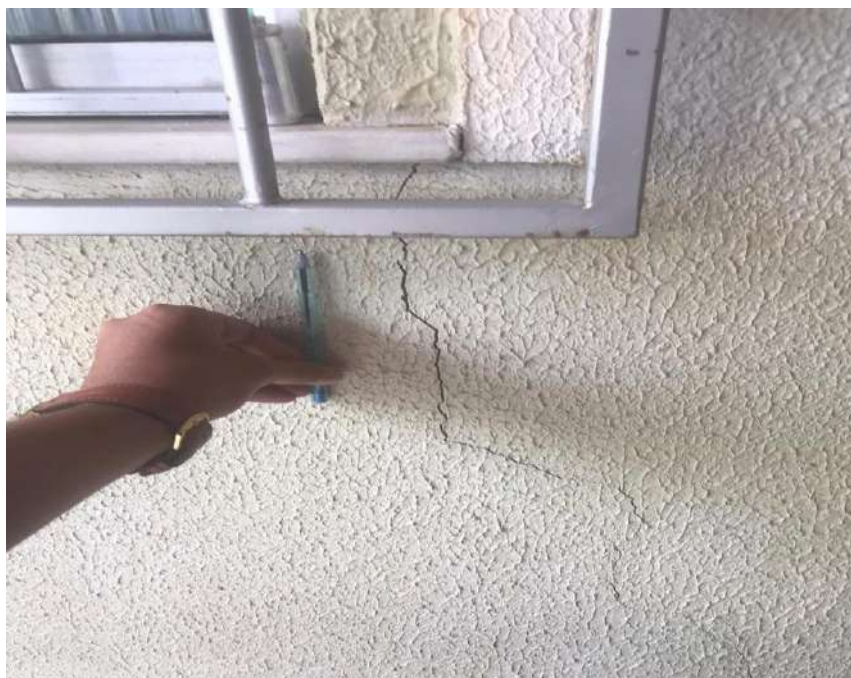
Figura 12 - Fissura na janela da Residência 1
