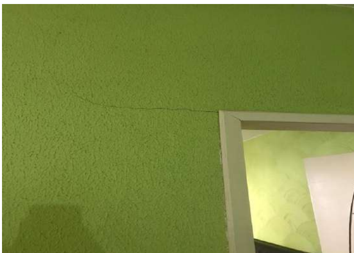
Figura 19 - Fissuras na extremidade da porta - Residência 3
